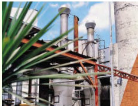
Unterstützung der Umweltprinzipien der UNO-Initiative Global Compact: Umstellung von Kohle auf Gas bei unserer Produktionsanlage in Graneros, Chile
