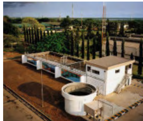
Die Abwasserkläranlage in der Fabrik in Agbara, Nigeria, fand allerseits hohe Anerkennung
